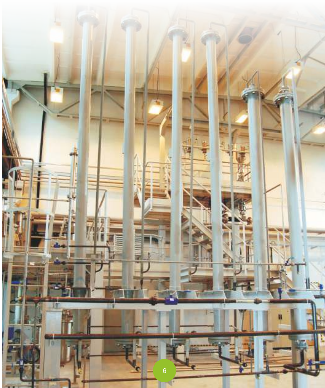
Instalacja do separacji gazów metodą adsorpcji zmiennociśnieniowej (PSA)
